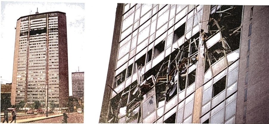
2002年4月、小型プロペラ機の衝突事故によって損傷。躯体には大きな被害影響は出なかった
